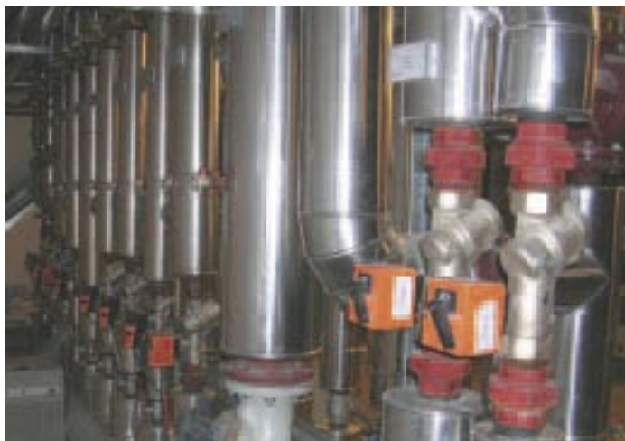
Der hydraulische Abgleich erübrigt sich mit den Druckunabhängigen Regel-Kugelhähnen und Hubventilen von Belimo, was Zeit, Kosten und Nerven spart
