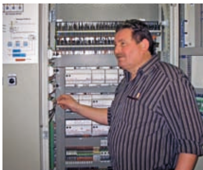
Reinhold Buschle stellt am Fan Optimiser die Parameter \dot{V}_{MIN} und \dot{V}_{MAX} der Volumenstromregler ein.
