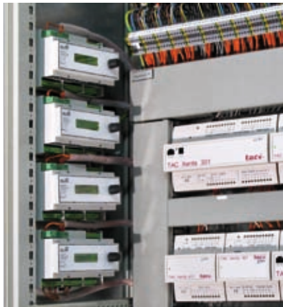
Die vier Fan Optimiser (links) und die TAC-DDC-Regler.
