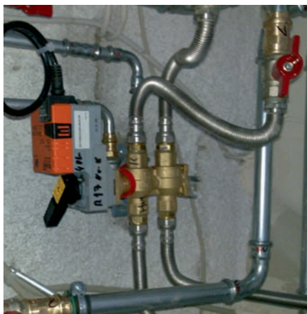
Ein 6-Wege-Regelkugelhahn im eingebauten Zustand (hinter einer abgehängten Decke im Flurbereich)
