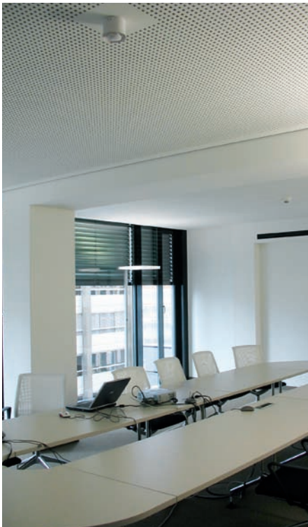
Im Westpol sind alle Büro- und Konferenzräume mit kombinierten Heiz-/Kühldecken ausgestattet und werden mit konditionierter Zuluft versorgt
