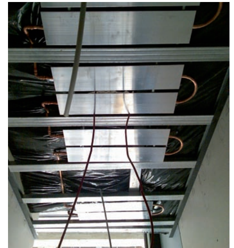
Die Heiz-/Kühldeckenelemente befinden sich hinter einer abgehängten, perforierten Gipskartondecke
