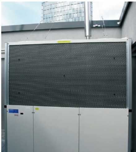
Zur Erzeugung der Heiz- und Kälteleistung kommen im Westpol drei mit Erdgas betriebene umschaltbare Wärmepumpen/Kältemaschinen zum Einsatz (Aufstellung auf dem Gebäudedach).
