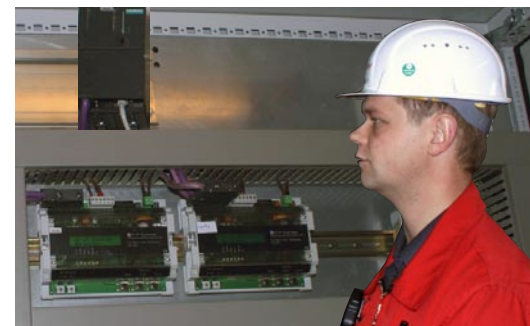
Der Bauleiter von ExxonMobil, Helmut Blekker, vor dem Schaltschrank mit der Prozessautomationsstation (oben) sowie den Profibus/MP-Bus-Gateways (unten).
